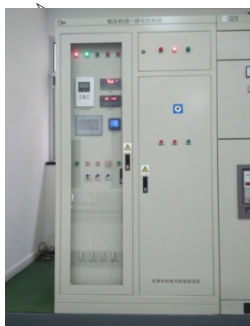
图1 秦皇岛石河水电站低压机组一体化智能装置柜体
