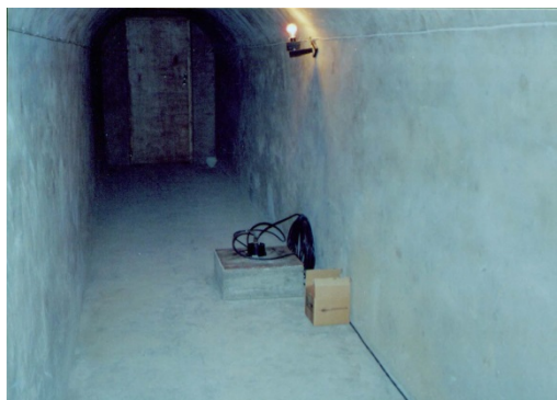
图 2 克孜尔大坝右坝肩山洞内基岩强震监测点
