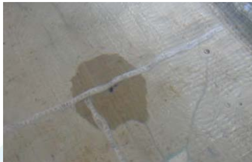
图7 渗漏水在 GCL 上的径向扩散
